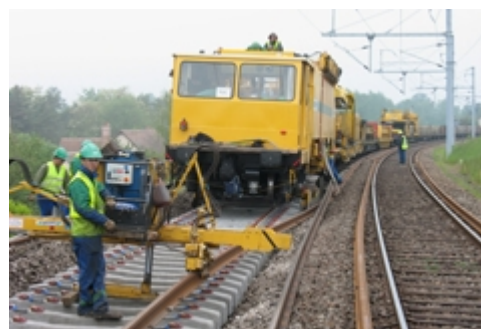
Longs Rails soudés sur traverses béton
